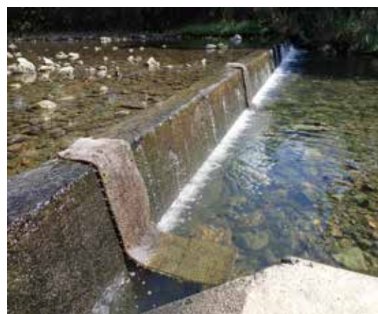
写真 1 芝マット魚道の状況
